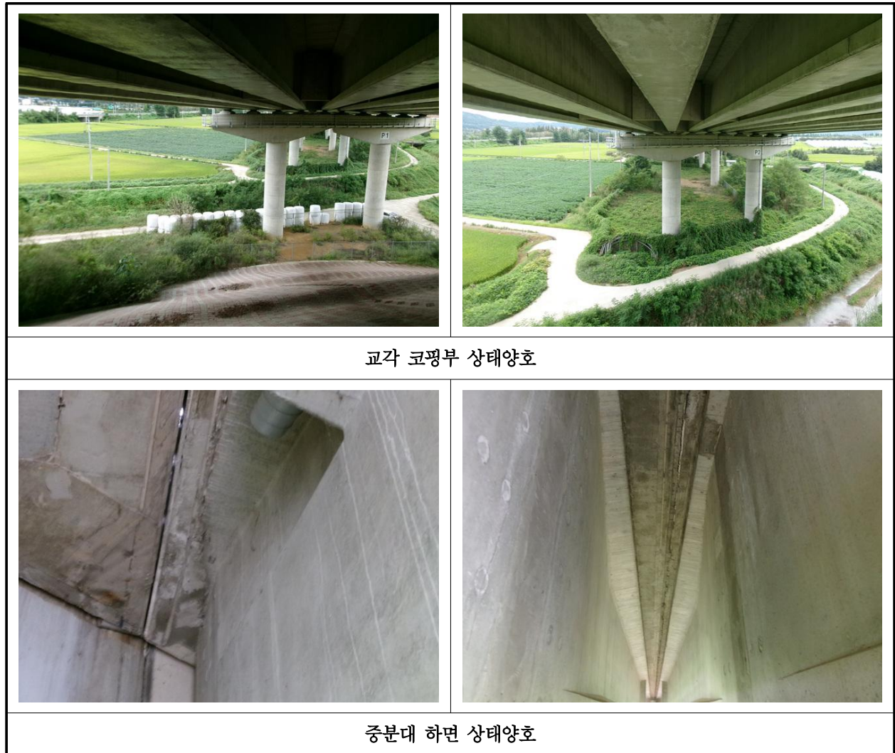
【사진 4.3.28】 교량의 공중이용시설 10대 위험요소 손상현황
